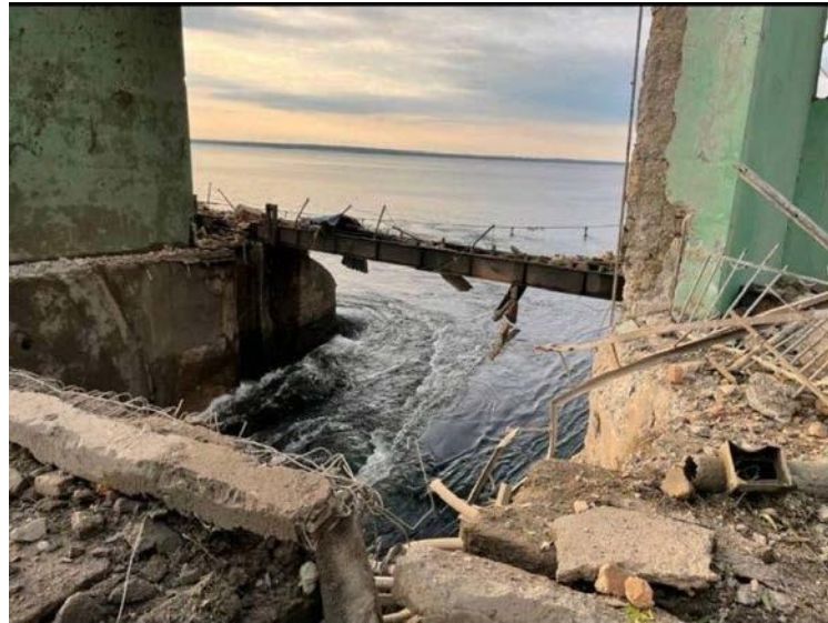
Рис. 1 – Приклад пошкодження гідротехнічної споруди внаслідок воєнних дій (Карачунівське водосховище)
