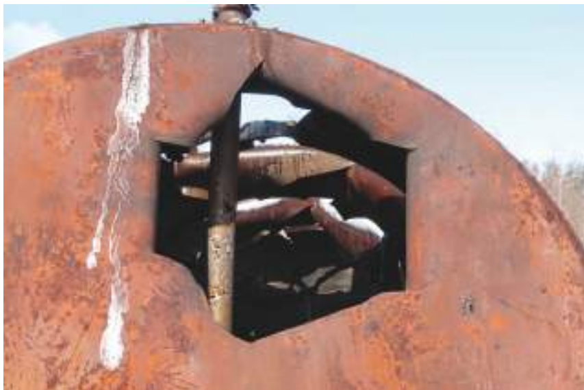
а) пробоїна у резервуарі
